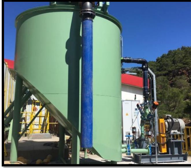
Şekil 34. Sanfrüj Aktarma Pompası
